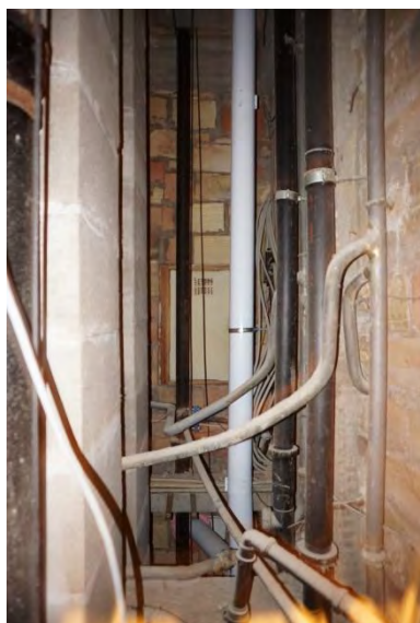
Foto 71 - Schacht appartement 703, indeling binnenin schacht
