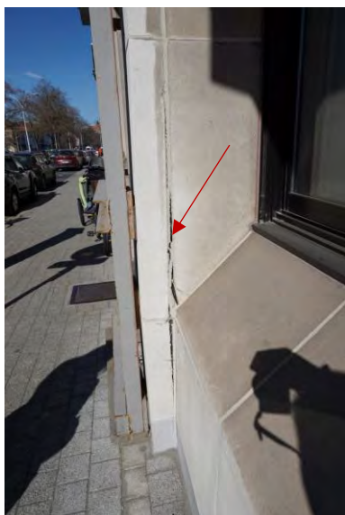
Foto 28 - Panelen knikken naar voren, langse scheur kitvoeg
