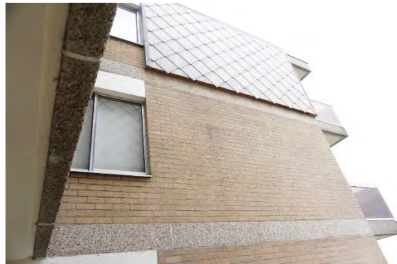
Foto 77 - Leien bovenste verdieping – beperkte opbouw
