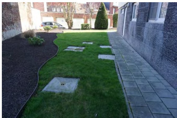
Foto 91 - Dekfels septische putten aan zijkant perceel
