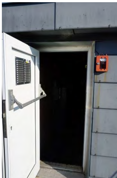
Foto 12 - Nooddeur volume liftmachinekamer
