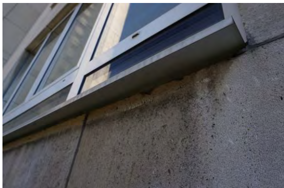
Foto 37 - Voorgevel – vervuiling onder alu dorpel
