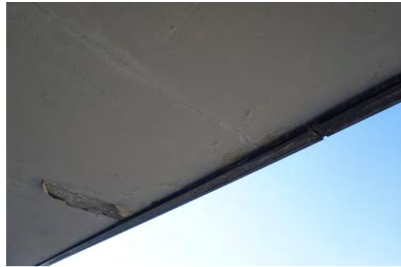
Foto 51 - Vochtschade onderzijde terras
