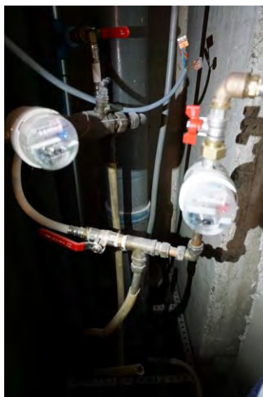
Foto 112 - Afgiftesysteem al vernieuwd – tellers in schacht
