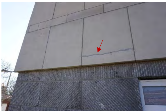
Foto 23 - Eerdere herstelling barst
