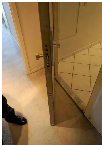
Foto 156 - Niet brandveilige inbraakwerende deur
