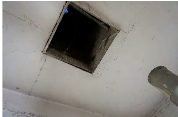
Foto 108 - Vroegere vuilschacht - asbesthoudend
