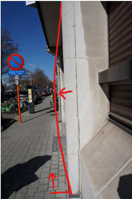
afbeelding 07 Ter illustratie: verticale scheuren door uitknikken natuursteen panelen
