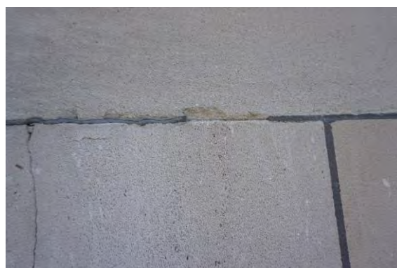
Foto 38 - Voegwerk gebarsten, verticale scheur – natuursteenpaneel klinkt hol rond barst en rond voeg
