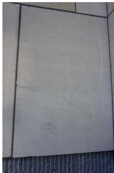
Foto 40 - Diagonale scheur in hoek zijde voorgevel, paneel klinkt lokaal hol
