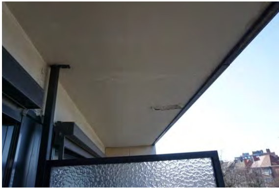
Foto 50 - Vochtschade onderzijde terras
