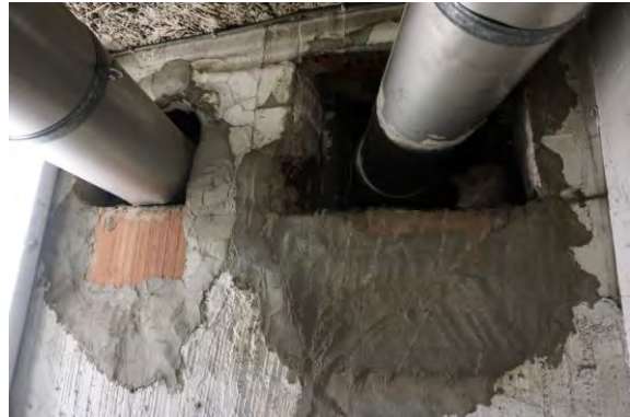
Foto 106 - Stookplaats – verdeling naar schachten
