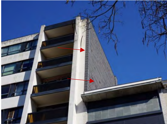
Foto 101 - Rechter zijgevel – leien – plaatselijk loskomende leien
