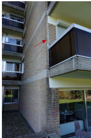
Foto 73 - Verticale barst in gevelsteen
