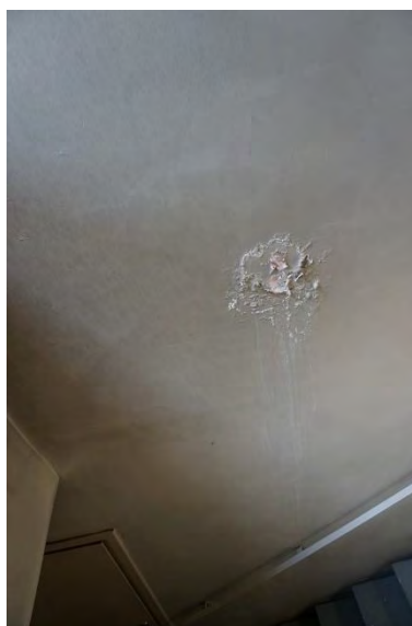
Foto 155 - Vochtplek in plafond traphal
