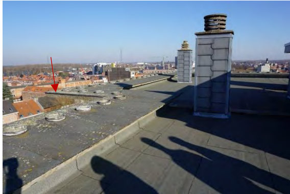
Foto 01 - Kroonlijst met mogelijk asbesthoudende buizen
