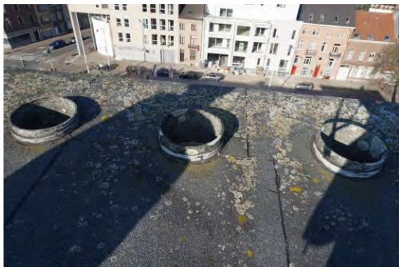
Foto 03 - Detail mogelijk asbesthoudende buizen doorheen kroonlijst
