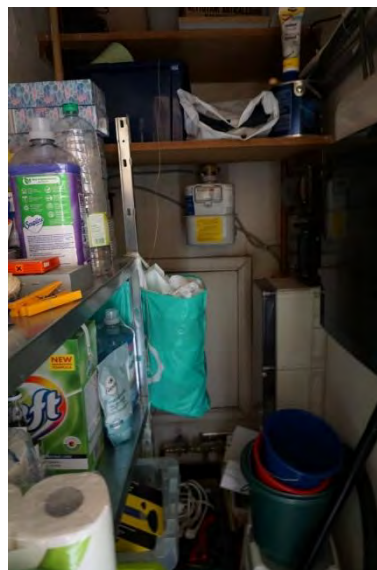
Foto 70 - Toegang tot schacht in de berging van appartement 801 – compartimentering brand niet in orde
