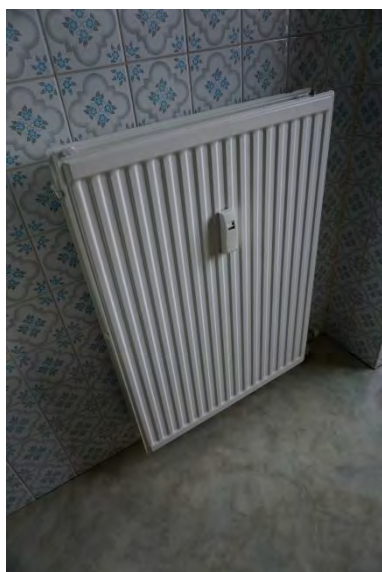
Foto 125 - Radiator in de keuken
