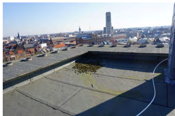
Foto 06 - Vervuiling, plaatselijke mosvorming
