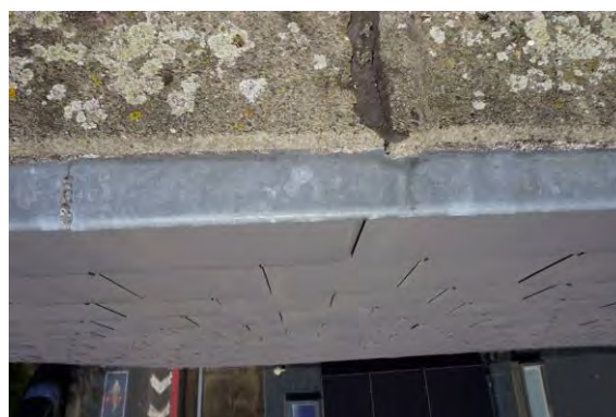
Foto 08 - Aansluiting dak en leien bovendakse zijgevel zijde ZO
