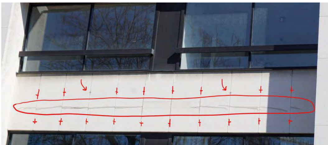
afbeelding 10 Ter illustratie: horizontale scheur, wellicht doorlopend, met op 2 plekken afschilferende zones ter hoogte van de bovenste ankerpennen, aanduiding vermoedelijke positie ankerpennen
