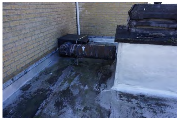
Foto 118 - Lucht/luchtwarmtepomp op dak, zie ook § 3.2
