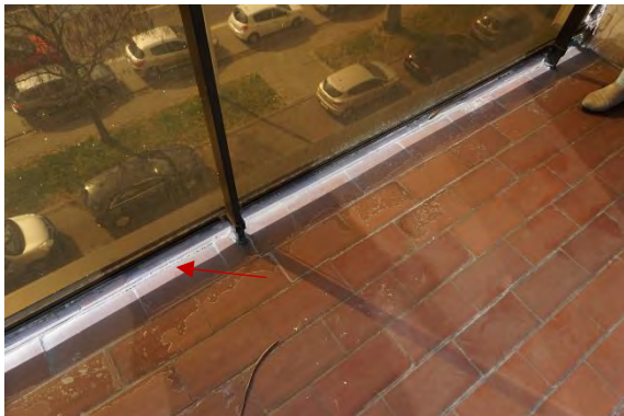
Foto 68 - Resten dichtingslaag / waterafstotende behandeling tegels
