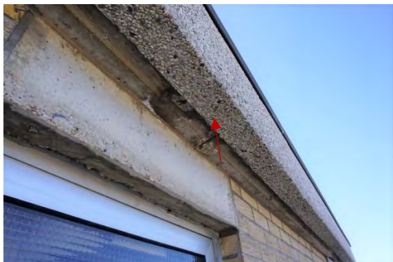
Foto 21 - Kroonlijst bovendakse volumes – wapening zichtbaar
