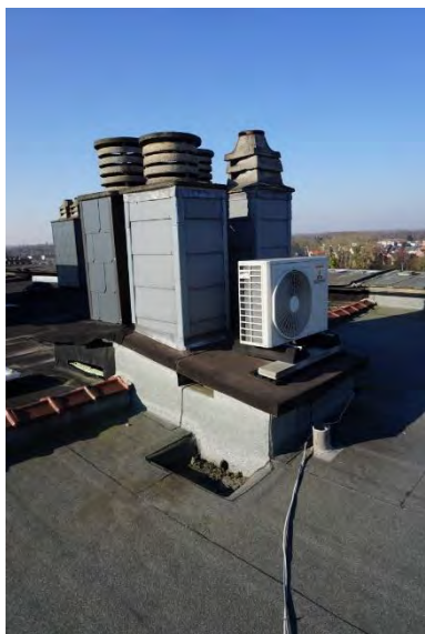
Foto 09 - Airco van appartement op verdieping 8
