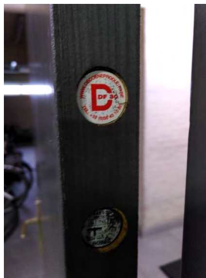
Foto 98 - Branddeur EI30 naar stooklokaal
