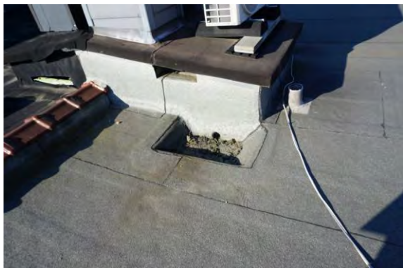
Foto 07 - Vervuiling t.h.v. tappunt & slordige aansluiting met burens van dichting op schouwafdek
