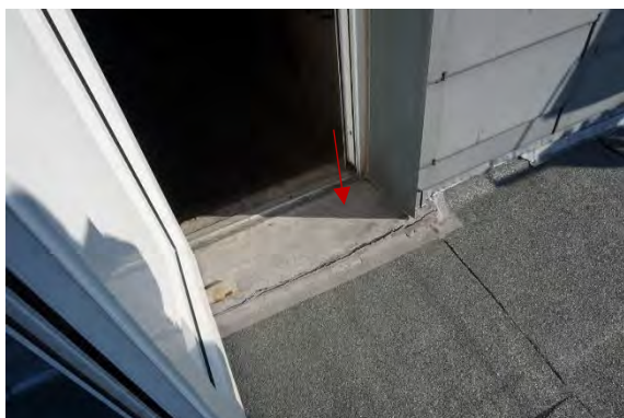
Foto 13 - Gescheurde vloeibare waterdichting dorpel liftmachinekamer
