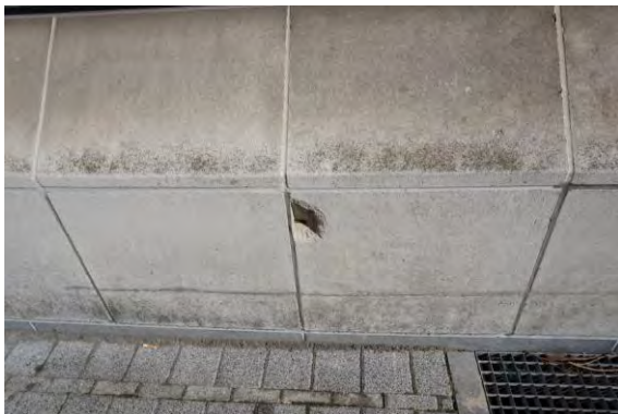
Foto 34 - Afschilferend zandsteen t.h.v. ankerpen
