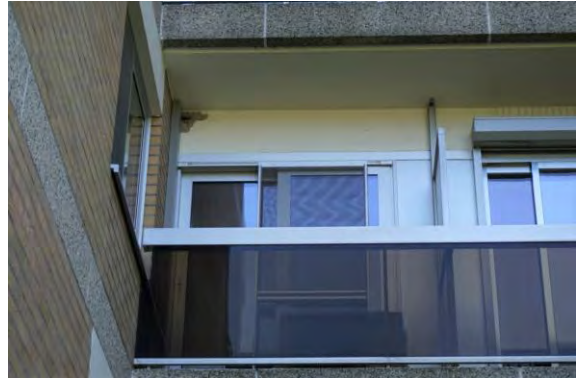
Foto 75 - Betonschade aan balk boven raam keuken (vanwege bevestiging element tegen gevel?)
