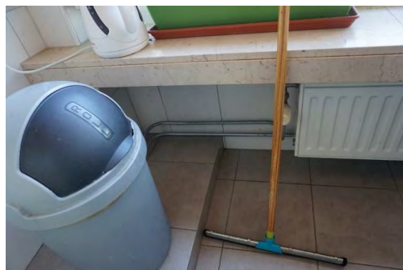
Foto 58 - Radiator in de muurdikte – app. 703
