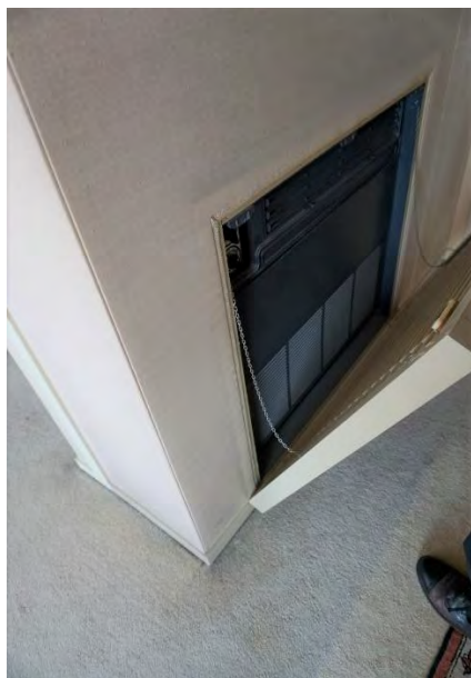
Foto 117 - Regel- en afgiftesysteem lucht/luchtwarmtepomp op dak
