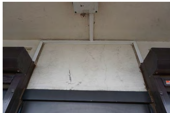
Foto 53 - Waterschade + afbladderende verf betonbalk boven ramen
