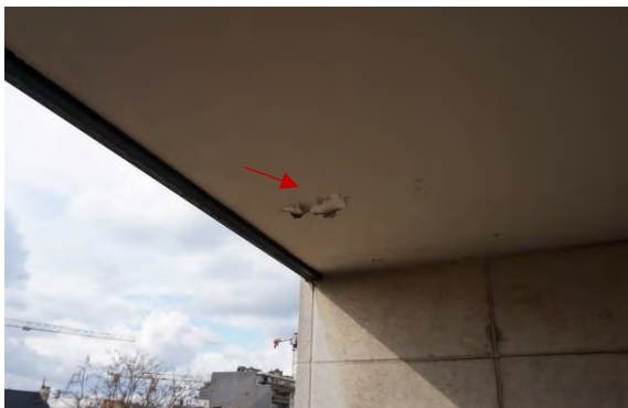
Foto 70 - Schade onderzijde terrasplaat
