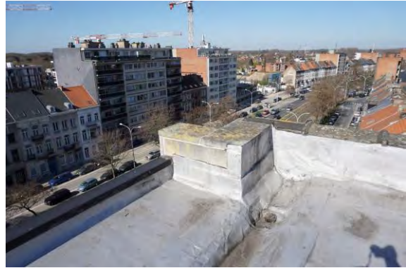
Foto 16 - Ingepakte dakopstand, geen deksteen of dakrandprofiel
