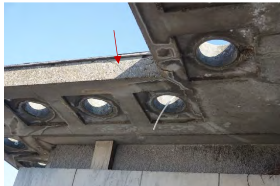
Foto 16 - Scheuren in beton
