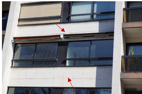
Foto 35 - Horizontale barst over verschillende panelen en verdiepingen
