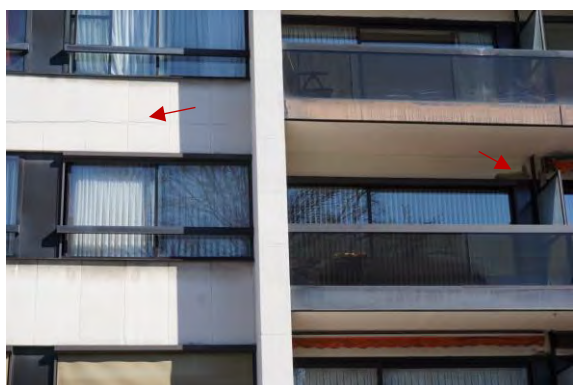
Foto 38 - barst in gevelpanelen en vochtschade betonbalk
