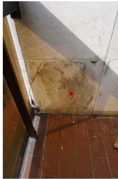
Foto 67 - Oppervlakte zandsteen beschadigd
