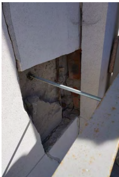
Foto 26 - Voorgevel – accidentele schade / opbouw zichtbaar
