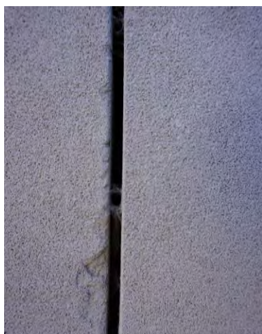
Foto 47 - Verticale voeg bijna volledig weggespoeld, achtergevel
