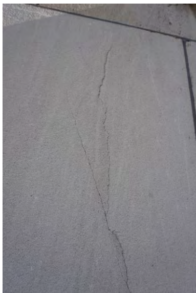
Foto 45 - Verticale scheur zijgevel, paneel klinkt bijna volledig hol
