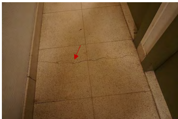
Foto 95 - Verdieping 08: gebarsten tegels
