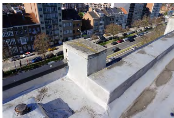
Foto 06 - Ingepakte dakopstand, geen deksteen of dakrandprofiel
