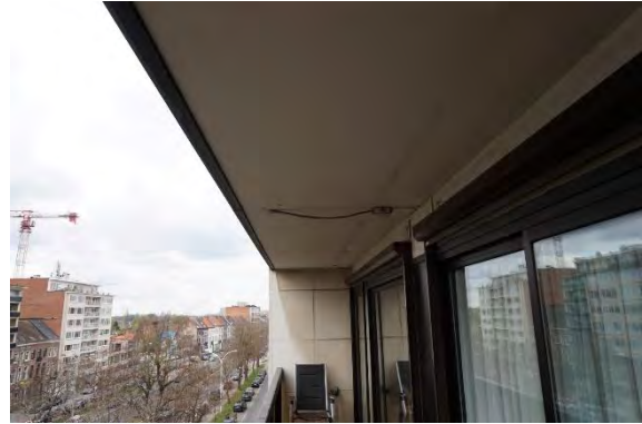
Foto 61 - Stroom lichtpunt dient voor de rolluiken en zonnewering
