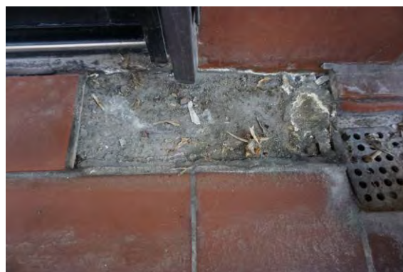
Foto 47 - Situatie onder losliggende tegel
