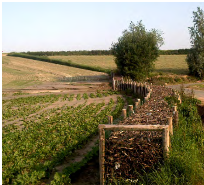
Een voorbeeld van een erosiedam, gemaakt van natuurlijke materialen (Provincie Limburg).
