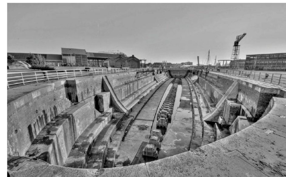
Voorbeeld van valbeveiliging van een historisch droogdok met hekwerk in Den Helder.
