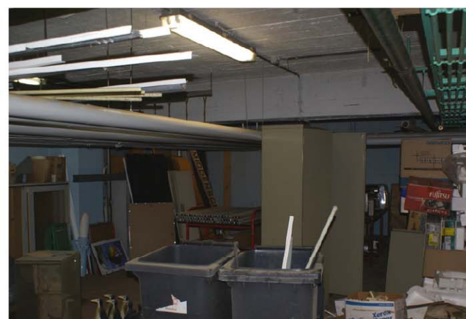
technisch lokaal balansventilatie
