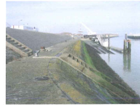
Op bestaande dijken geconstrueerde trappen
