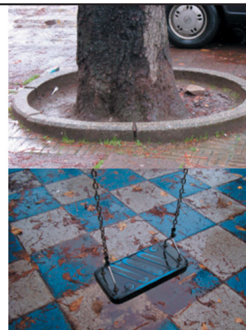
De bestaande verharding laat geen ruimte voor doorworteling. Onderzocht wordt of, en welke, bomen nog kunnen gered worden.
