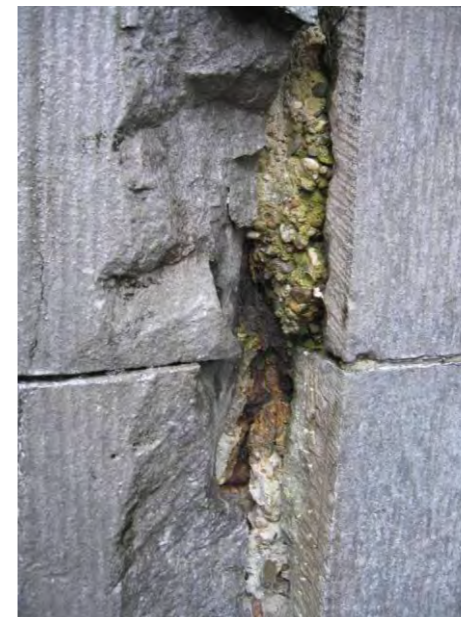
Roestende wapeningen in het beton achter de natuurstenen sokkel zwellen op en breken de natuursteen.
