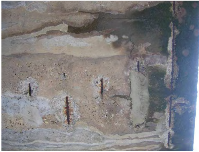
Roestende wapeningen in het beton aan de onderkant van de inkomluifels.
