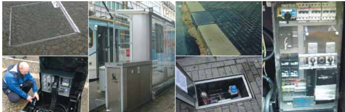
referentie ondergrondse nutsvoorzieningen
