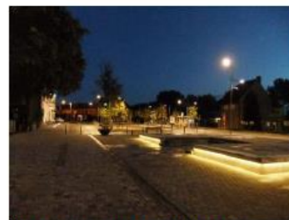
Verlichting van podium en plein
