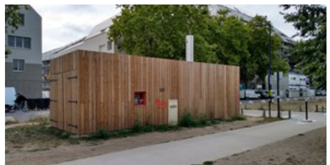
Voorbeeld tijdelijke stookinstallatie op aardgas (Bordeaux Rive Droite)
